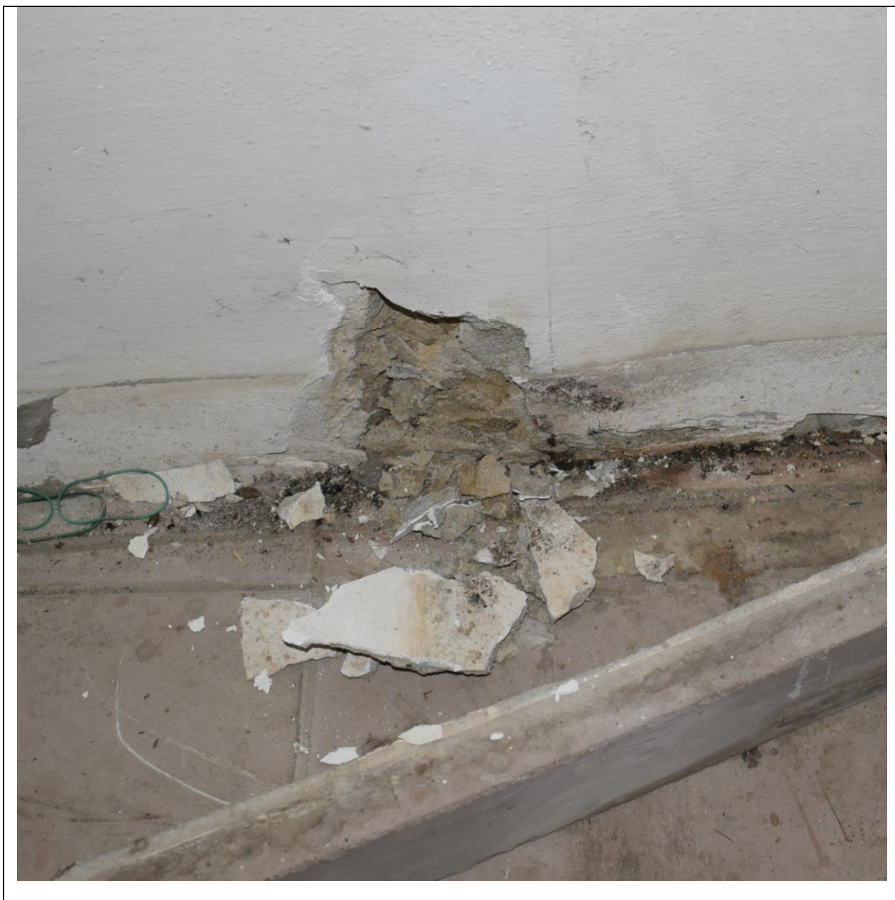
Фото 1. Місце саморозкриття тиньку у нижній частині стіни 3. Фото - М.Бевз.
