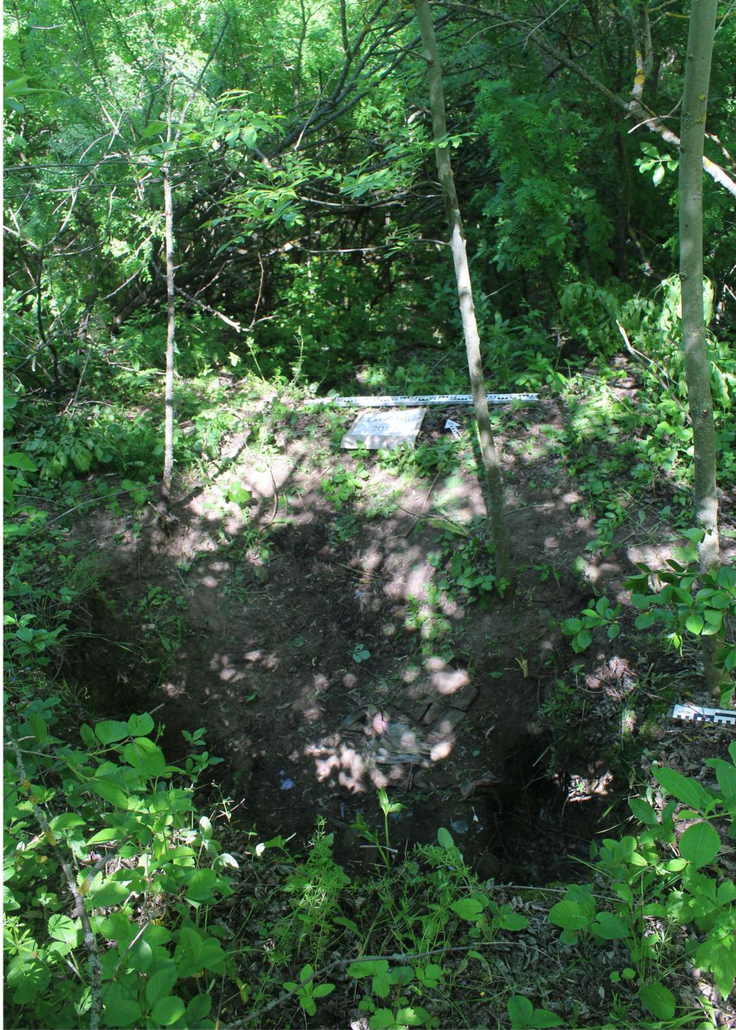
Рис.31. Просідання ґрунту на південь від сучасного входу в об'єкт №5.
